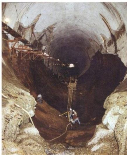
شکل ۱- آسیب ناشی از کاویتاسیون به تونل سمت چپ سد گلن کنین (فالوی، ۱۹۹۰)
